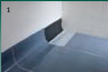
Bild 1: Elastilon auf vorbereitetem Unterboden auslegen, seitlich nicht überlappen, an der Wand ca. 2,5 Dielenbreiten hochstehen lassen.
