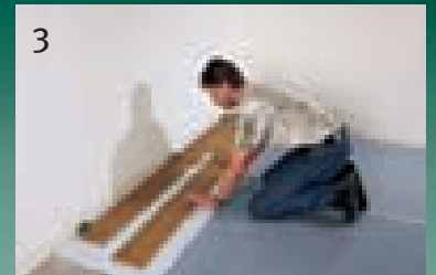
Bild 3: Verlegen Sie zwei Reihen Dielen auf die doppelt liegende Schutzfolie und richten Sie diese mit dem vorgeschriebenen Wandabstand aus.
